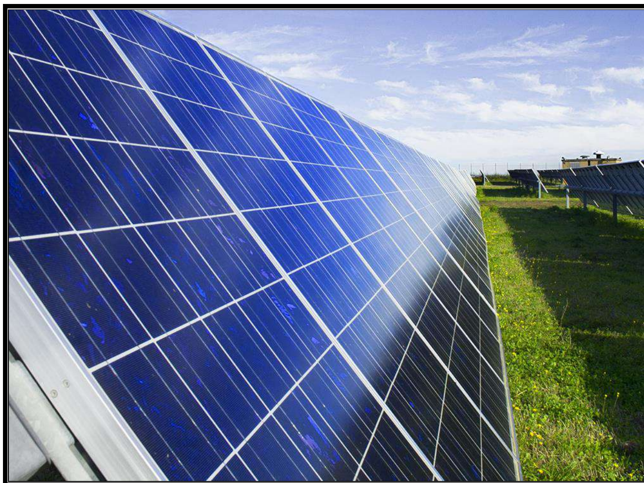
Figura 6- ESEMPIO DI INSTALLAZIONE TRACKER
