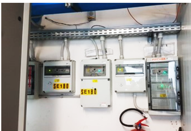
Foto 1: automazione svuotamento vasca
