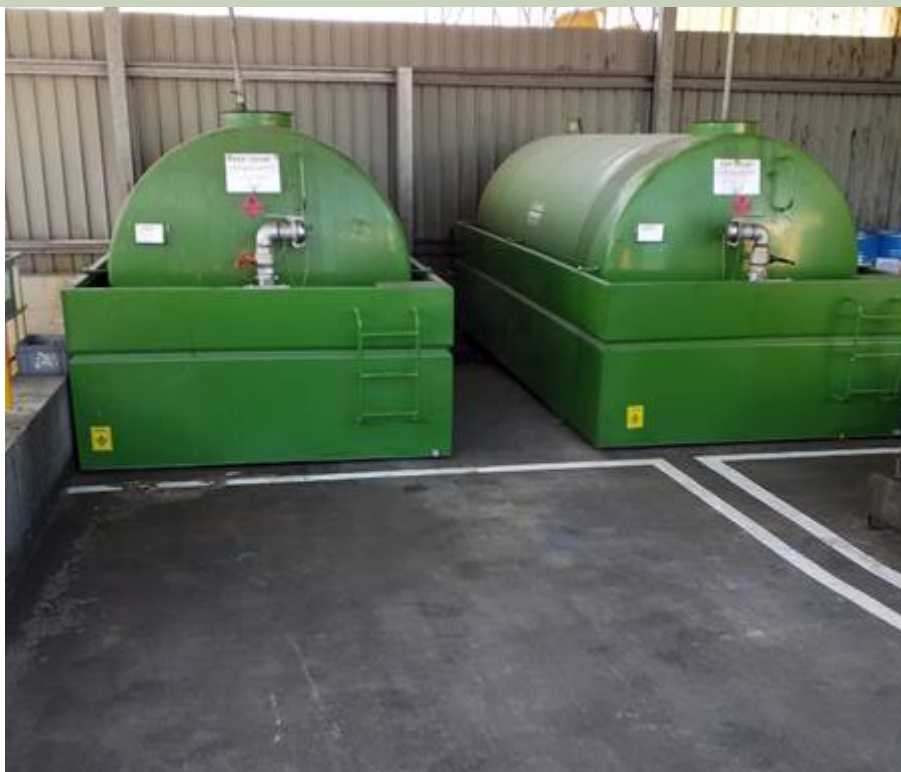
Foto 4: deposito temporaneo del rifiuto codice EER 120109*
