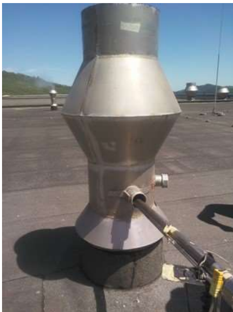
Foto 6: caldaia produzione vapore emissione 2P
