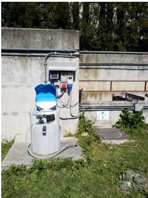
Foto 3: pozzetto di ispezione uscita trattamento
