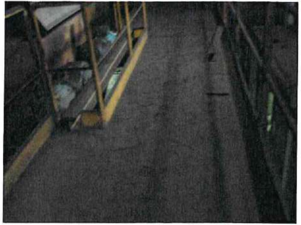
Spesso strato di polvere nera depositatasi al primo piano dell'impianto preparazione e miscelazione terre
