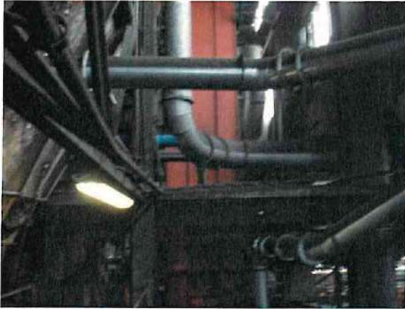
Polvere nera depositatasi sulle tubazioni dell'impianto preparazione e miscelazione terre poste in alto
