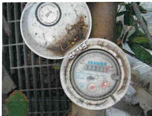
Contatore in uscita dalla vasca V2 di accumulo acque meteoriche da riutilizzare nel ciclo produttivo – 09 aprile 2019
