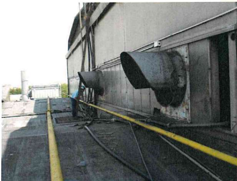
Le due ventole di espulsione poste sopra il reparto Preparazione/Miscelazione Terre e finestra ancora aperta
