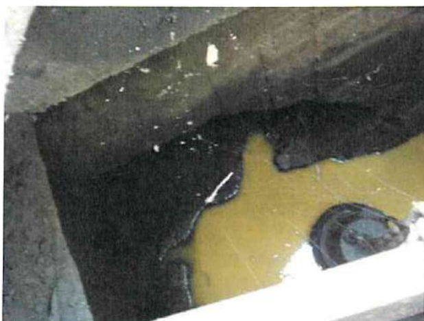
Interno pozzetto di sollevamento acque meteoriche con presenza di sostanza oleosa giallastra
