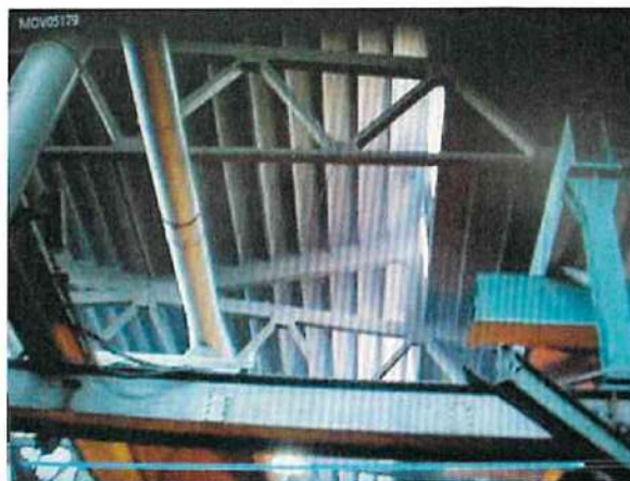
Fumi non captati del forno di colata nella parte alta del reparto espulsi tramite ventole
