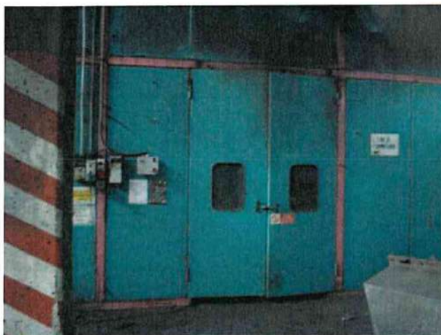
Pannellatura reparto distaffatura
