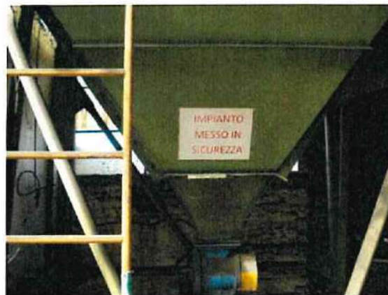
Cartellonistica impianto dismesso e messo in sicurezza
