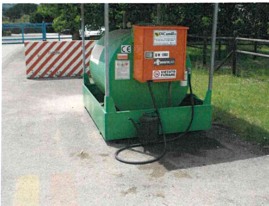
Area deposito carburante con evidenti tracce di pregressi sversamenti
