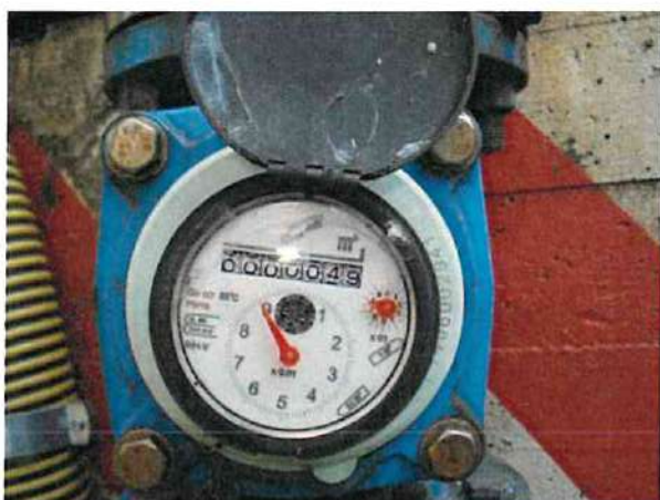
Contatore non funzionante ingresso vasca V1 di raccolta acque I pioggia
