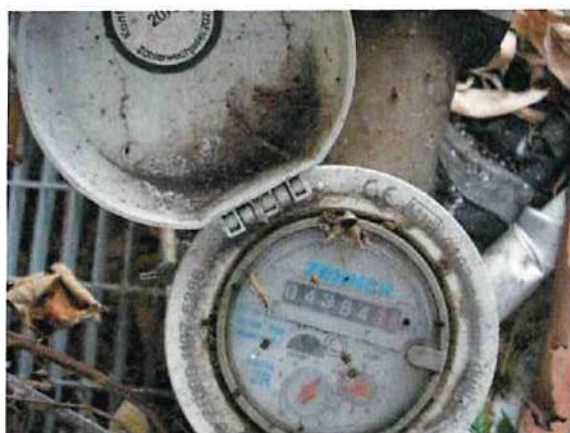
Contatore in uscita dalla vasca V2 di accumulo acque meteoriche da riutilizzare nel ciclo produttivo – 24 settembre 2019
