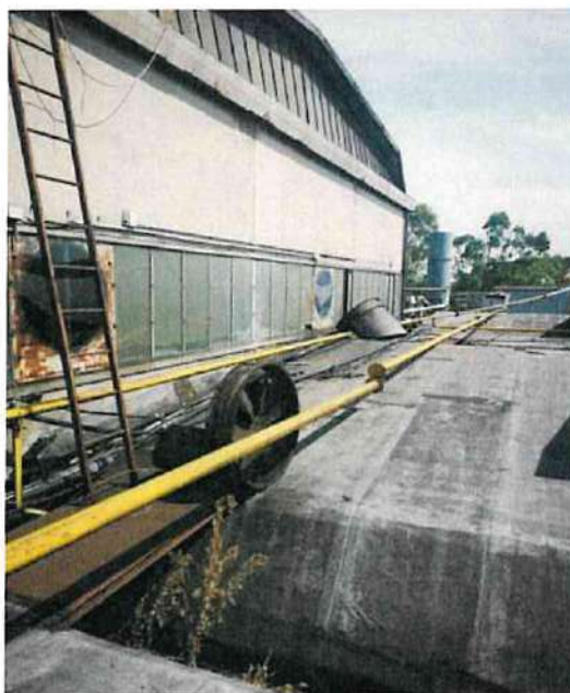
Le due ventole di espulsione dismesse poste sopra il reparto Preparazione/Miscelazione Terre e fori chiusi con plexiglass
