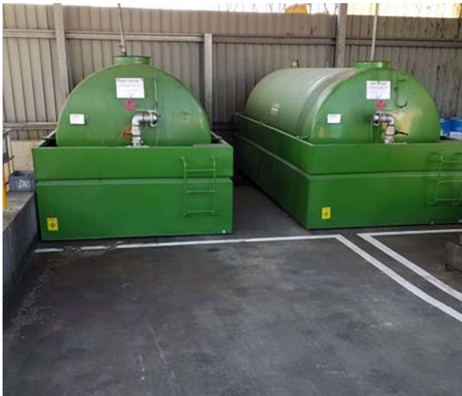
Foto 2: deposito temporaneo del rifiuto codice EER 120109*
