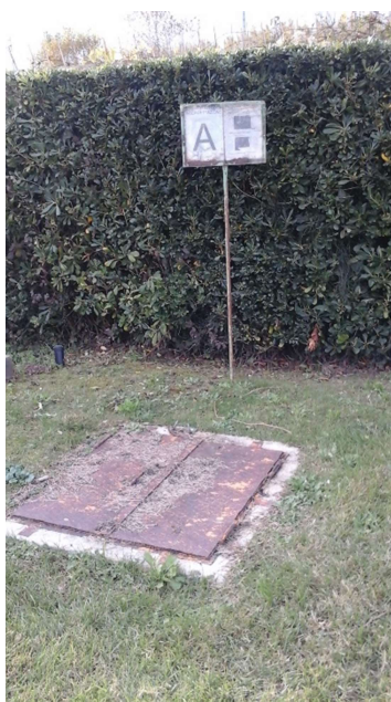
Foto 1: Uscita scarico parziale S1
