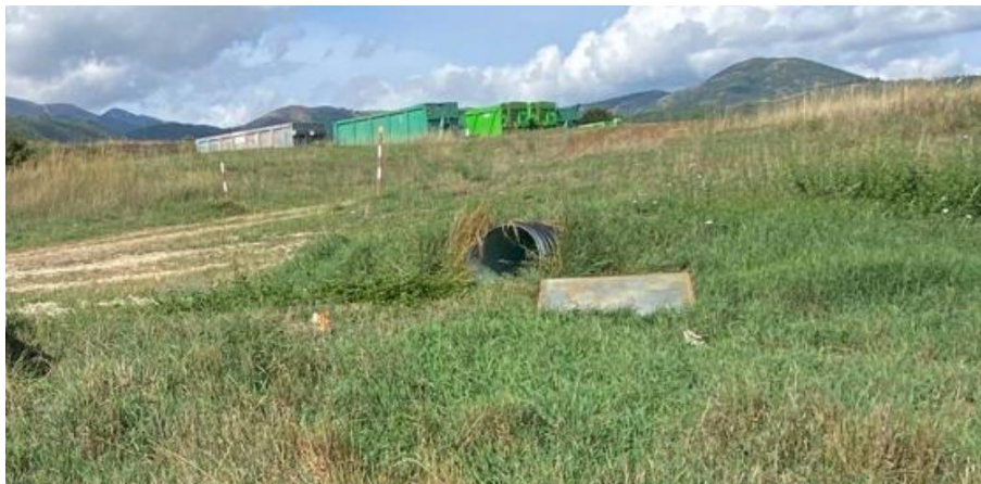
Vista della tubazione impiegata per l'aspirazione del percolato
