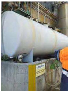
Foto 6. Zona B deposito EER 070101*
