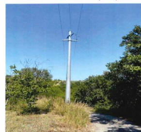
Foto 19 linea aerea esistente (Penne)
