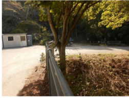
Foto n. 10 Particolare di piante di acero vegetante a ridosso della spalla destra del ponte in territorio di Molina Aterno che verrà tagliate
