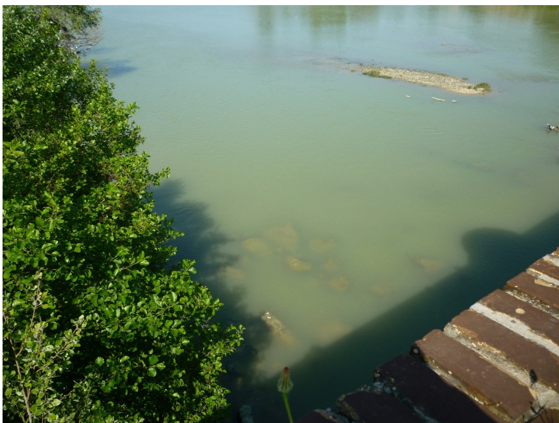
Foto 55 – lato ponte da cui si accede per rimuovere gli isolotti A-B-C. Si mette in evidenza la presenza di massi sotto il pelo dell'acqua.
