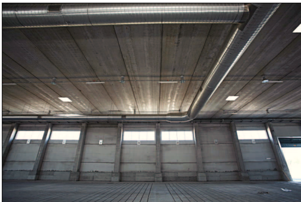
Figura 29: Panoramica dell'edificio di maturazione con platee insufflate.
