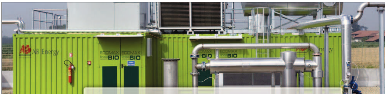
Figura 52: Motore di cogenerazione.
