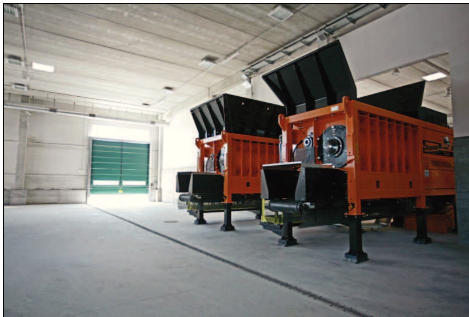
Figura 36: Il trituratore di destra verrà destinato al pretrattamento dei rifiuti compostabili.
