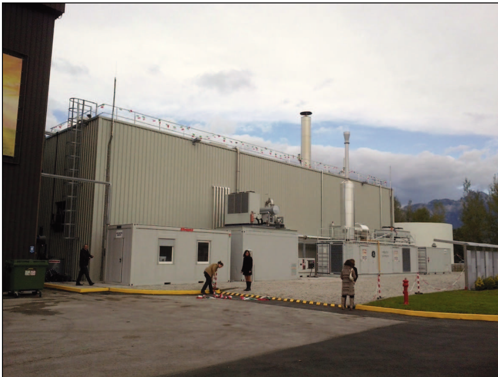
Figura 46: Immagine di un modulo di digestione anaerobica (Impianto di S.Giustina Bellunese – BL).
