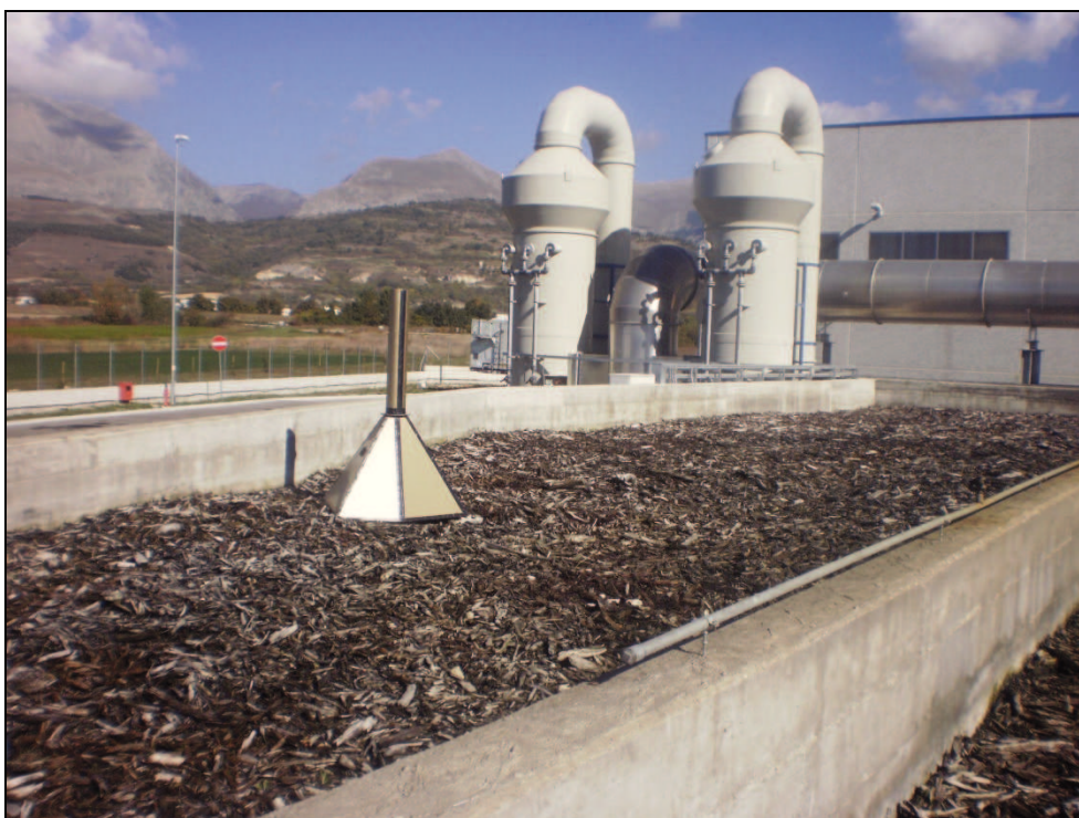
Figura 58: Attuale biofiltro a servizio dell’impianto.
