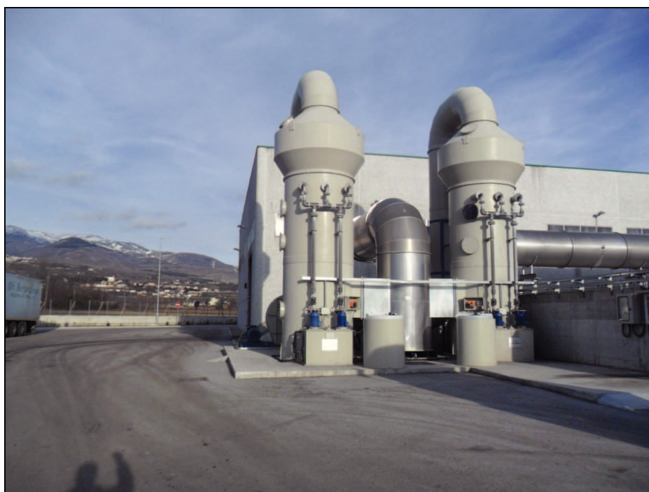
Figura 59: Scrubbers per il trattamento dell'aria prima dell'avvio al biofiltro
