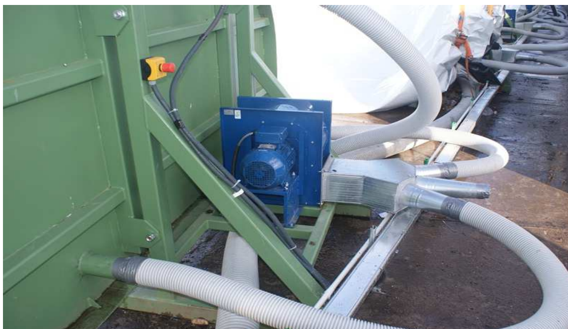
Foto 5: particolare delle dimensioni della soffiante e dei tubi di insufflazione (Ø 10 cm.)
