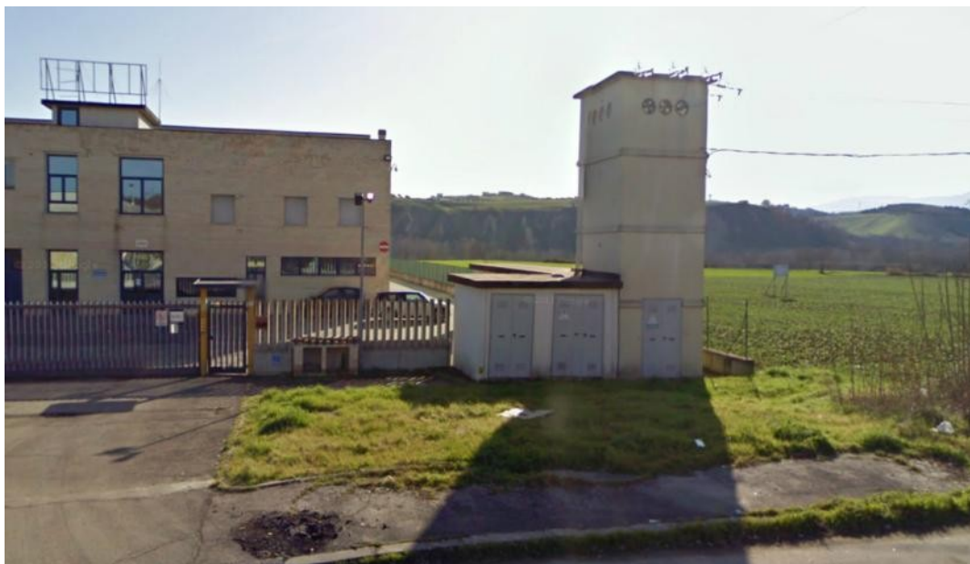
Fig. 3.8 – Cabina elettrica di distribuzione
