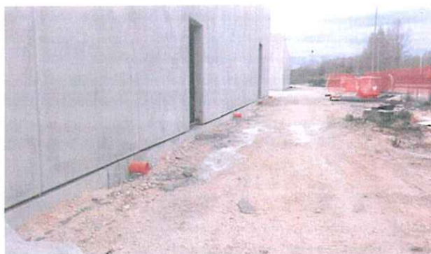
Foto 2 – Area Carica – Scarico: Tubature Pluviali ancora da collegare al collettore generale
