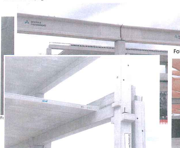
Foto 8 – Edificio Blocco 01: Particolare ancoraggi sismici da completare
