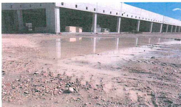
Foto 3 – Piazzale frontale: Tubature Pluviali ancora da collegare al collettore generale comune di Cepagatti
