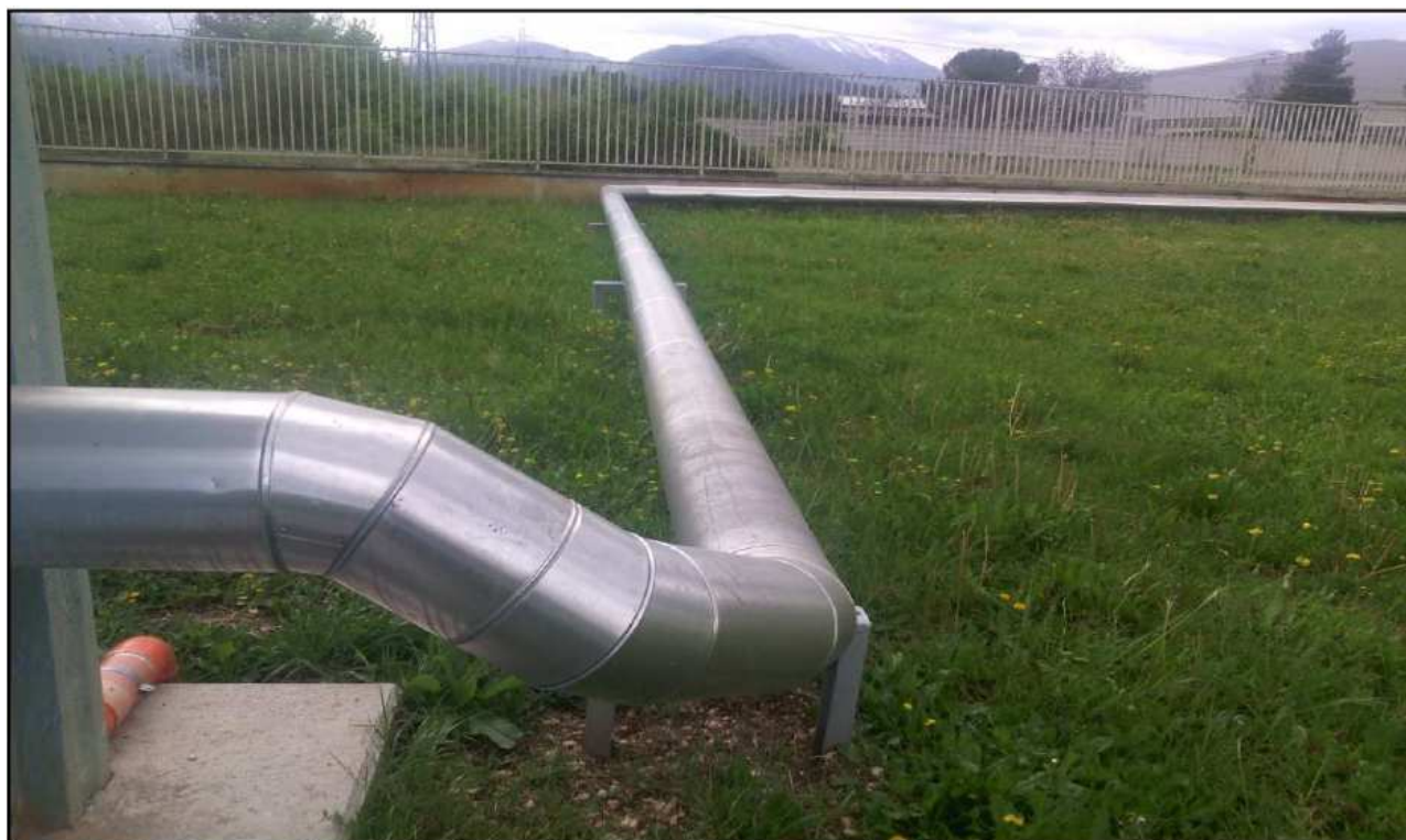
Fig. 13 Particolare della tubazione di convogliamento ai serbatoi di stoccaggio
