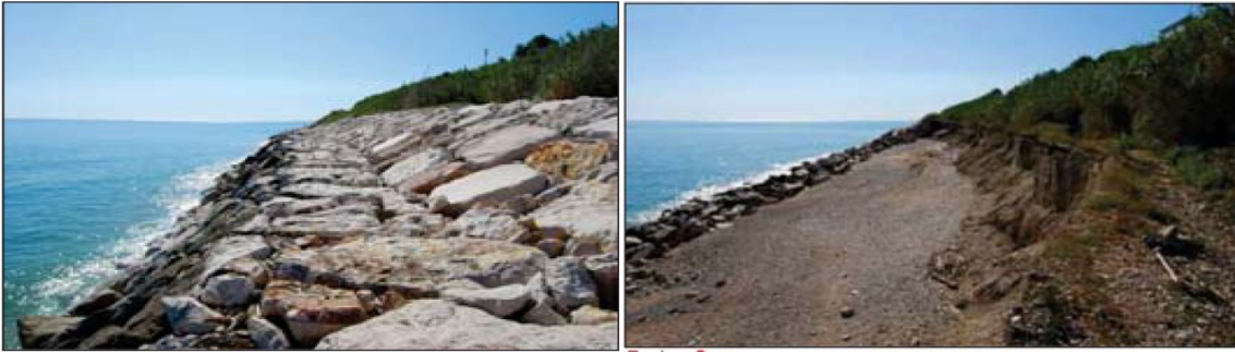
Foto 1 – Difesa radente; Foto 2 – Zona oggetto dello smottamento.
