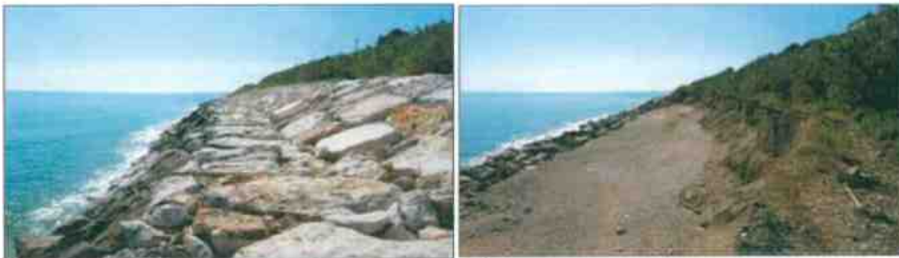
Foto 1 – Difesa radente; Foto 2 – Zona oggetto dello smottamento.
