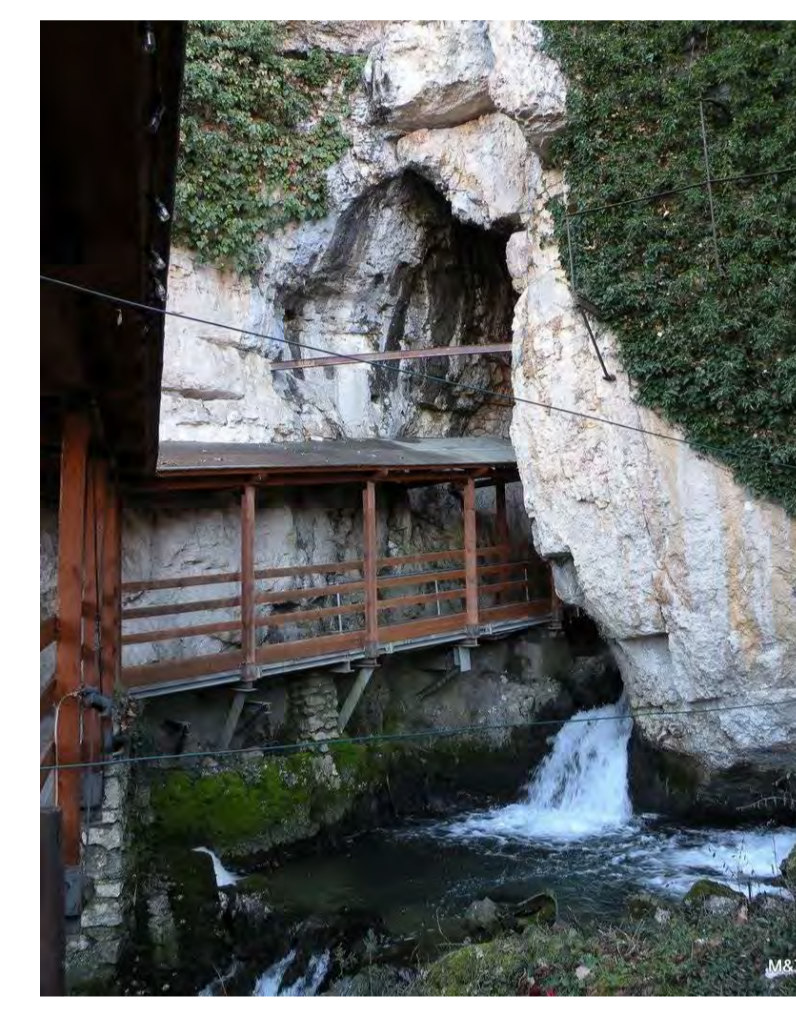
Foto 3 - Vista del bacino di scarico con accesso alle grotte e sito della nuova briglia di sfioro
