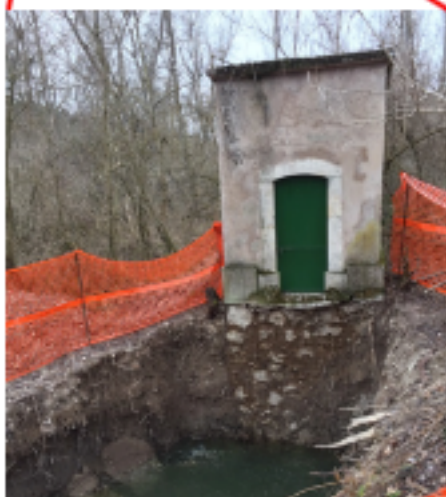
Figura 9 Evidenza fotografica delle aree di captazione e del serbatoio di accumulo
