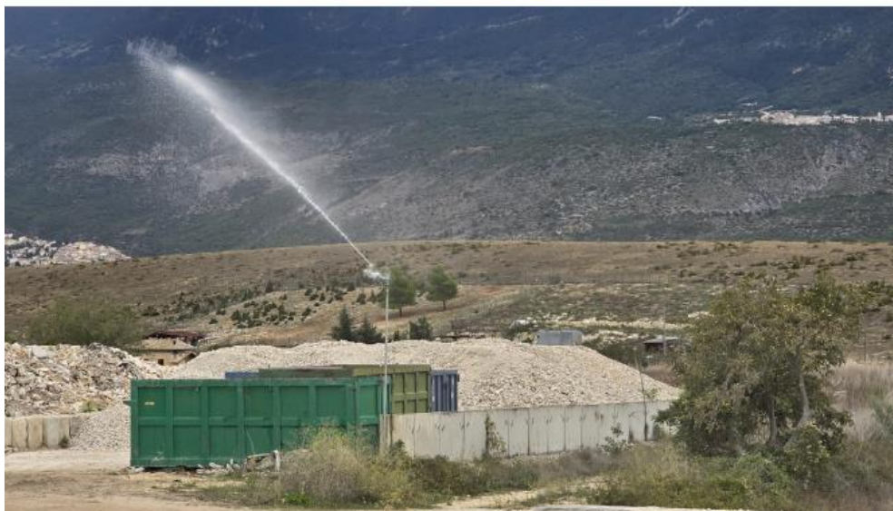
Foto 6 - Rete ugelli nebulizzatori per abbattimento polverosità –Area di messa in riserva
