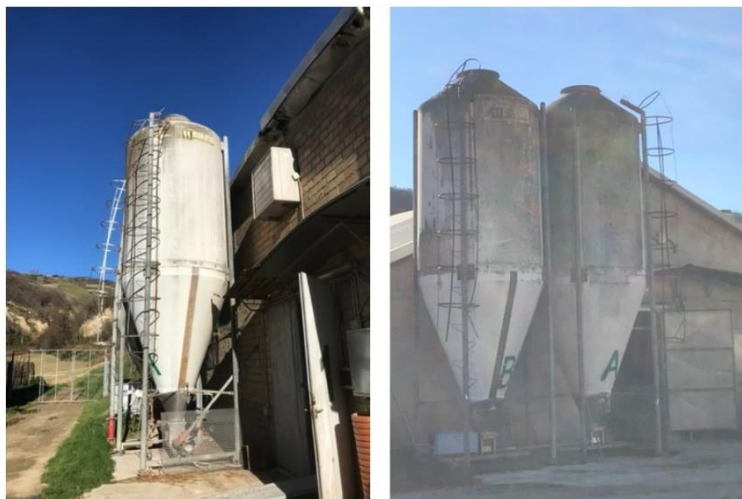
Figura 16 - Silos stoccaggio mangime
