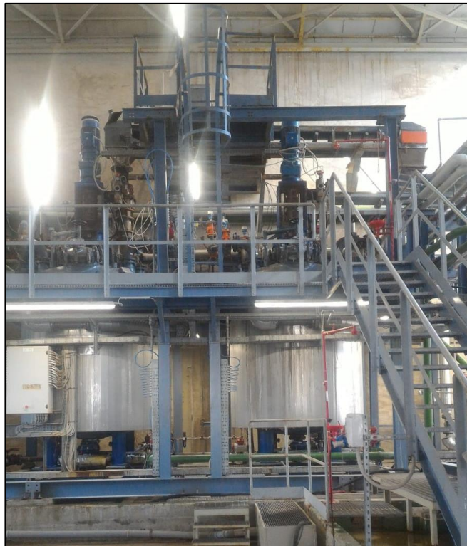
Figura 4: Reattori e impalcato costituenti l'impianto PAC
