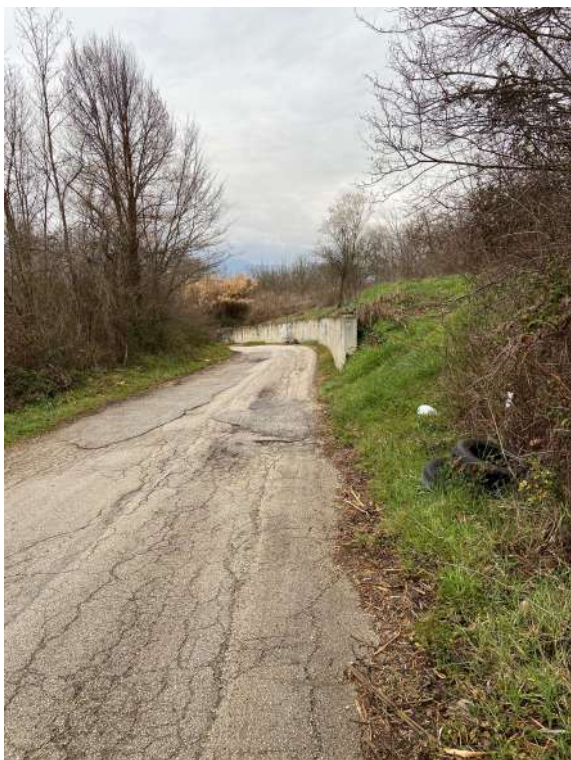
Foto 2. Immagine che rende evidente la disconnessione del manto stradale in prossimità di un tratto critico realizzato tramite sbancamento su terreni limo-argillosi.
