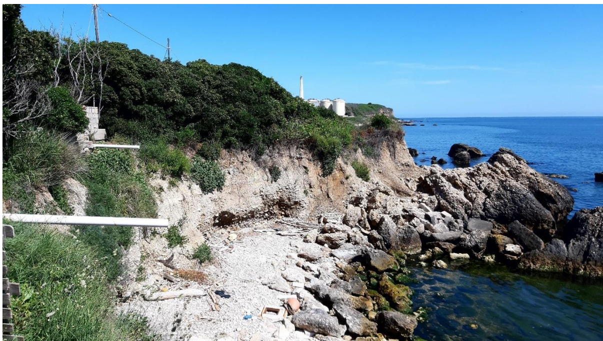
Figura 17 - Particolare della costa rocciosa a Nord della struttura ricettiva con gli evidenti segni del cedimento della falesia (a sinistra due canali di scarico di acque meteoriche privi del supporto del terreno; sullo sfondo lo stabilimento ECOFOX)
