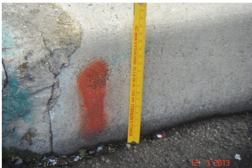
Foto 24. Particolare della misurazione dell'alzata del marciapiede da cui si evince l'errata progettazione della rampa.
