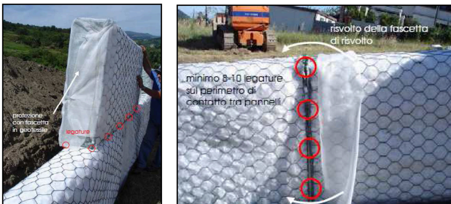
Fig.3: Assemblaggio tra le diverse file di pannelli sino ad altezza prestabilita (a sx) e tra i diversi pannelli (sotto a dx).
