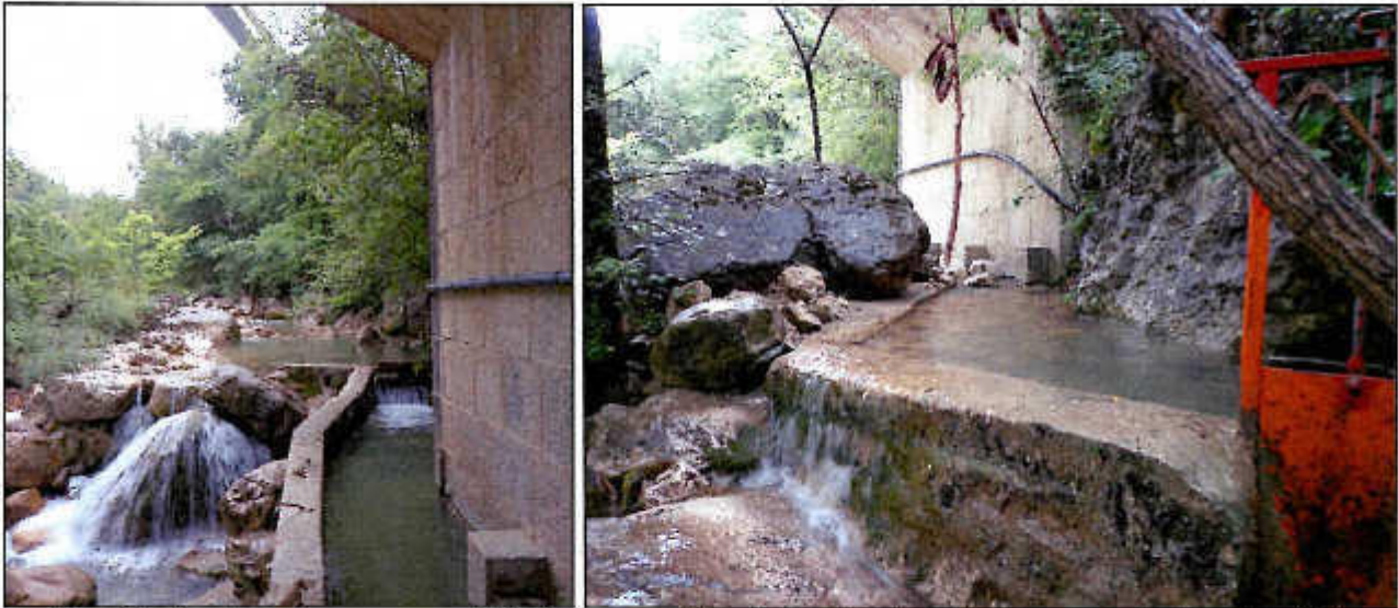
Foto 4-5. Paratoia di presa con griglia (sx); vasca di carico con troppo pieno e paratoia di scarico (dx).
