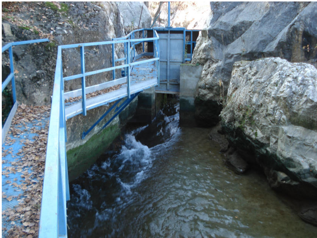
Invaso con paratia di presa sul Fiume Sangro. Opera preesistente.
