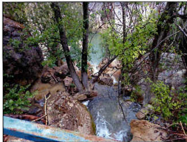
Foto 3. Scarico del troppo pieno
