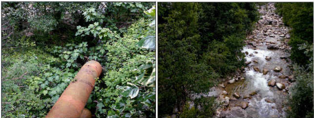
Foto 6-7. Tubo terminale di rilascio (sx) e punto di rilascio visto dal ponte sul fiume Sangro (dx).
