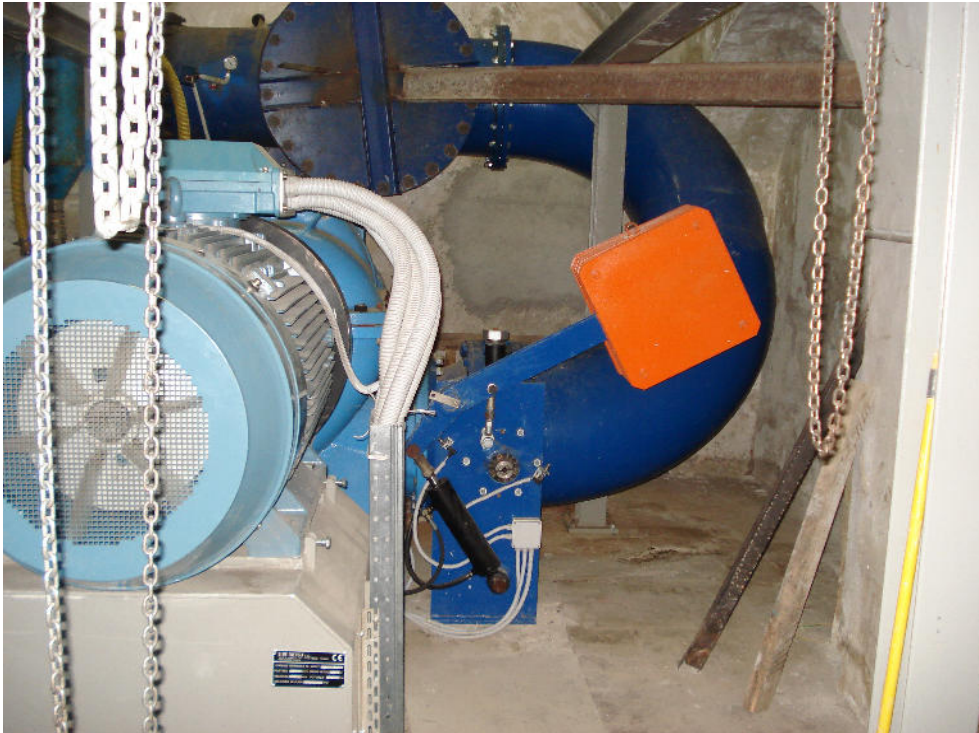
Locale Centrale idroelettrica, ambiente preesistente.
