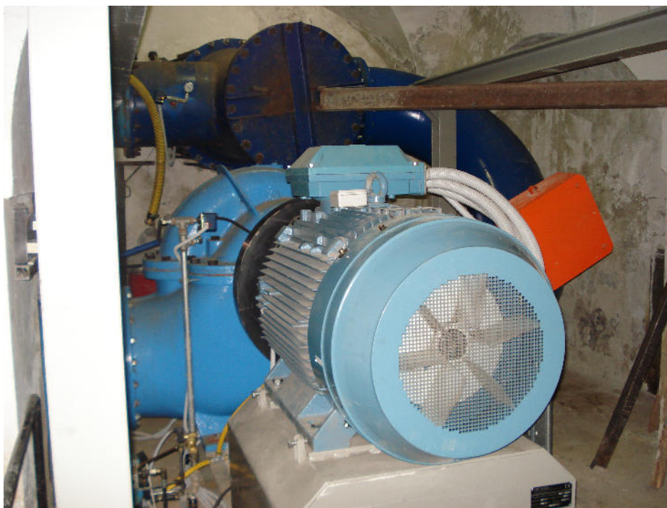
Turbina nel locale Centrale nel Piano Seminterrato del Fabbricato comunale
