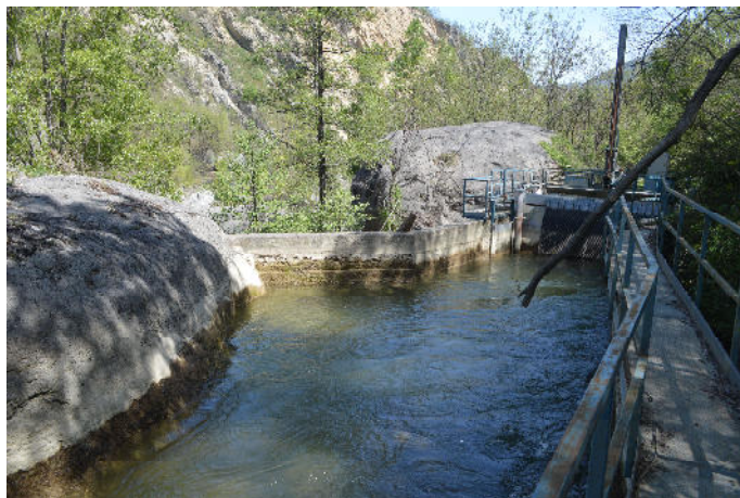
Vasca di carico sul Fiume Sangro.
