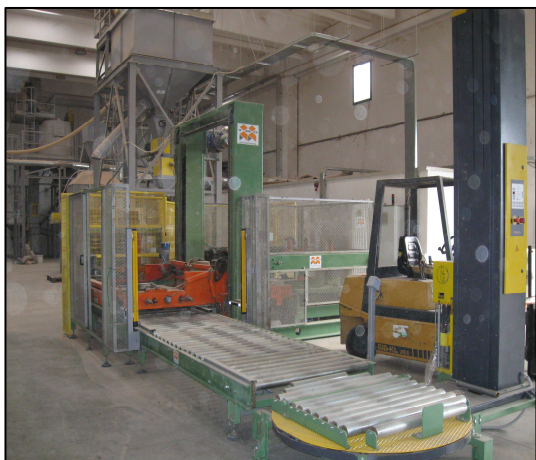
PIATTAFORMA A: Impianto di produzione pellets - SETTORE 9
