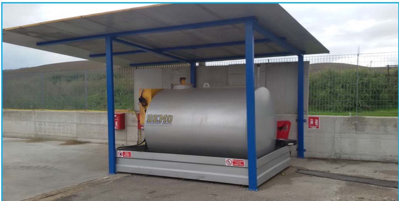
Fig. 17 - IMPIANTO DI RIFORNIMENTO GASOLIO
