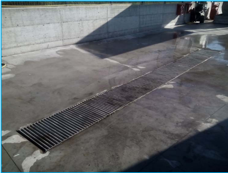
Fig. 13 - IMPIANTO DI LAVAGGIO AUTOMEZZI
