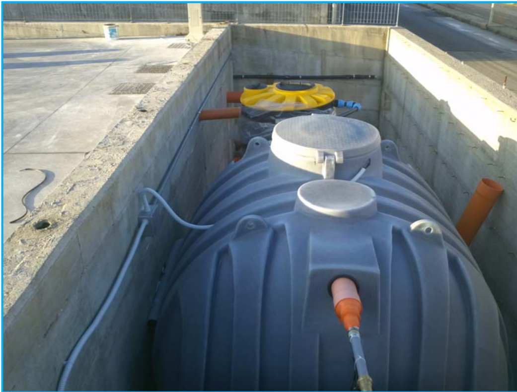
Fig. 16 - FOTOGRAFIA IMPIANTO DI TRATTAMENTO ACQUE DI PRIMA PIOGGIA
