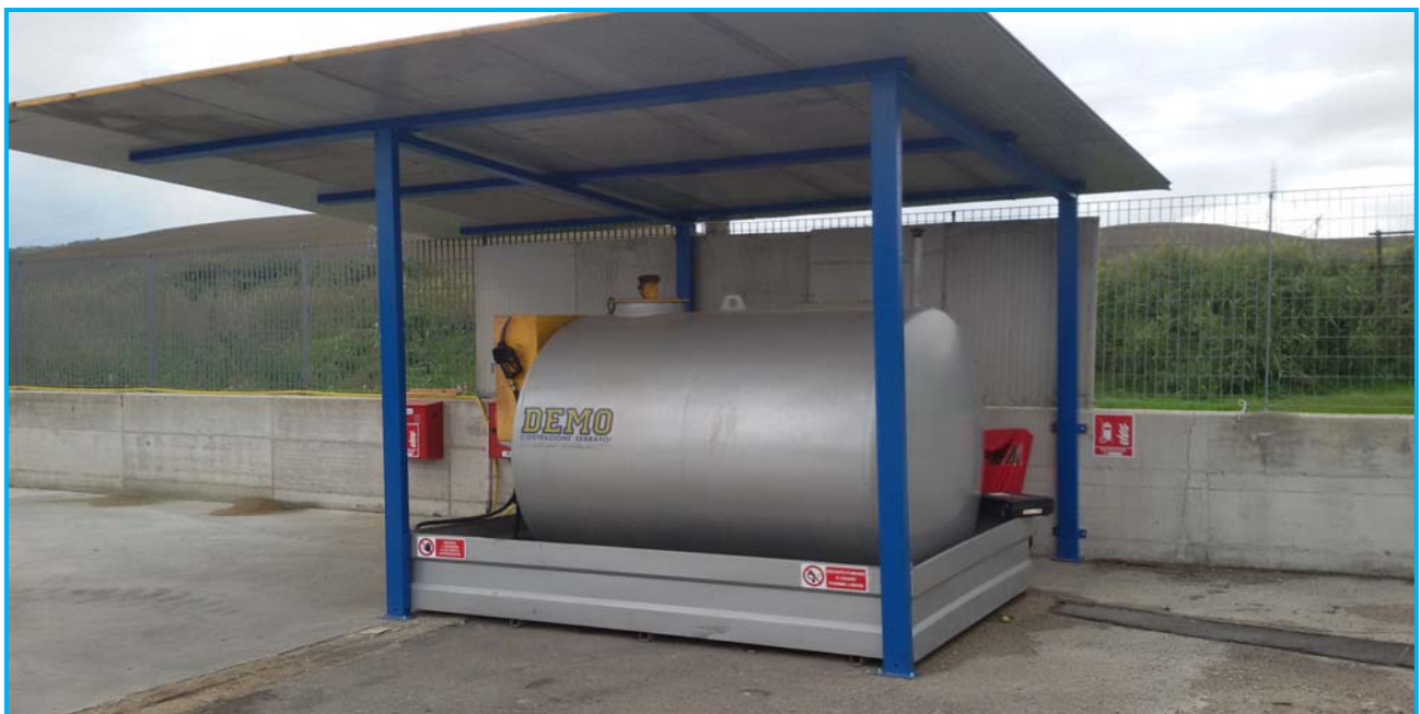
Fig. 17 - IMPIANTO DI RIFORNIMENTO GASOLIO
