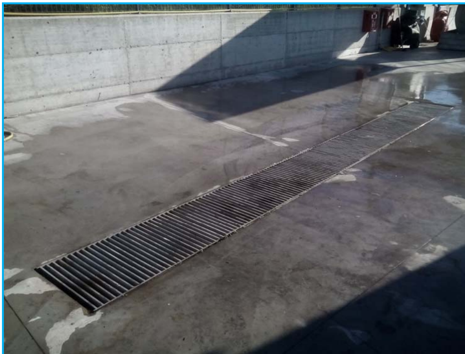
Fig. 13 - IMPIANTO DI LAVAGGIO AUTOMEZZI
