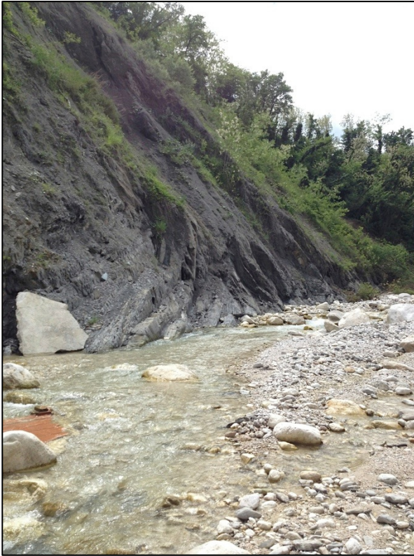
Figura 3-5 - Sponda in destra idrografica sulla quale deve essere realizzato l'intervento di difesa mediante la collocazione di una gabbionata
