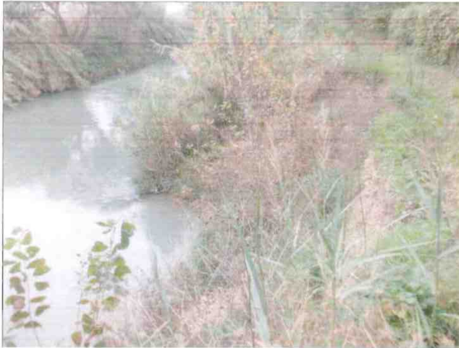
Figura 4- erosione della sponda destra con eccessiva vegetazione e accumuli di materiale di piena nell'alveo del fiume;
