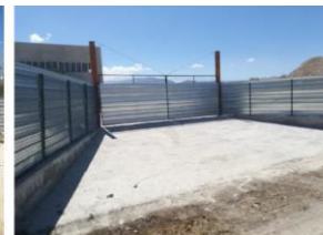
Ingresso indipendente lato nord impianto di recupero rifiuti (foto scattata dall'esterno del sito)
