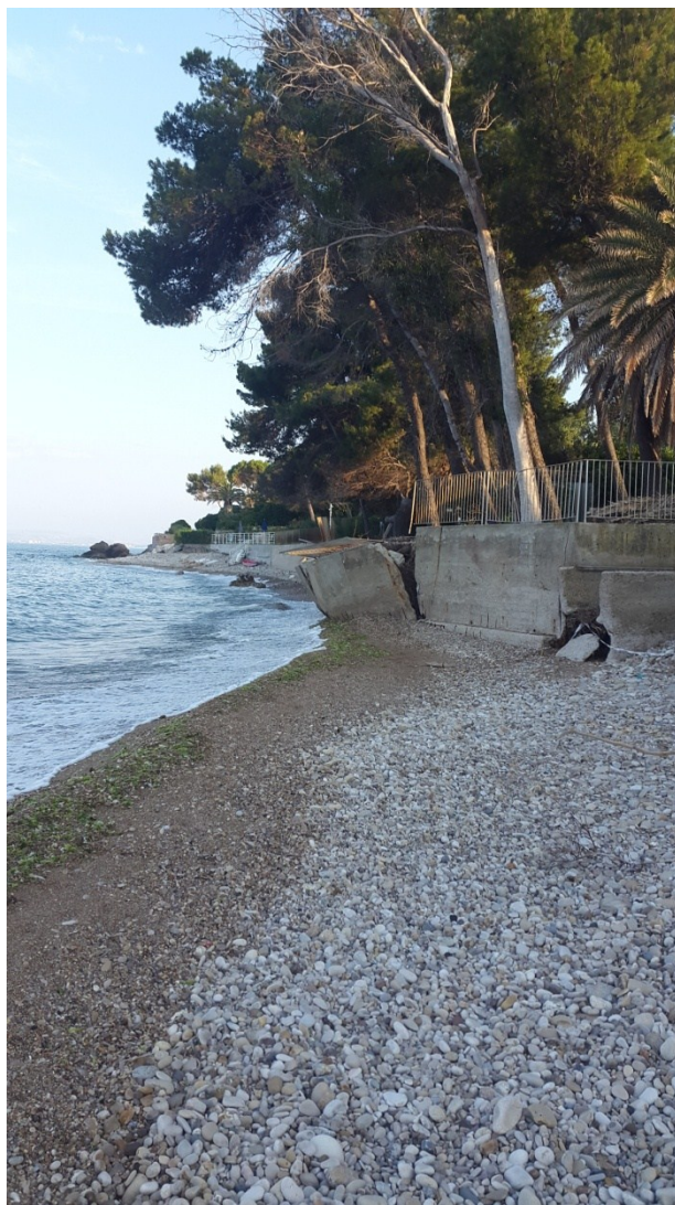
Vista del tratto di muro da pericolante
