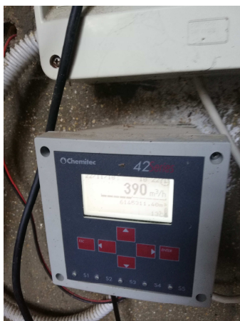
Misuratore di portata in uscita dall'impianto (acque provenienti dalla clorazione)
