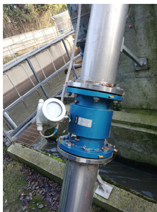
Misuratore di portata in ingresso all'impianto (acque provenienti dalla nuova zona residenziale)
