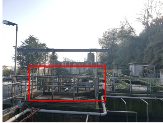
Bacino di sollevamento (costituito da n. 3 pompe)
