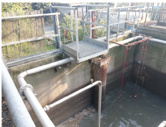
"Troppo pieno" in corrispondenza della vasca di equalizzazione, su cui installare un misuratore di portata
