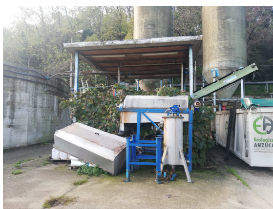
Nastropressa per disidratazione meccanica dei fanghi (NS)
