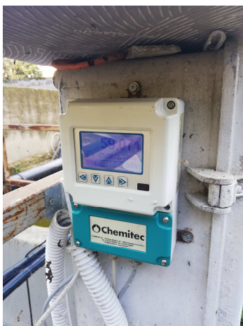
Misuratore di portata in uscita dall'impianto (acque provenienti dalla filtrazione)
