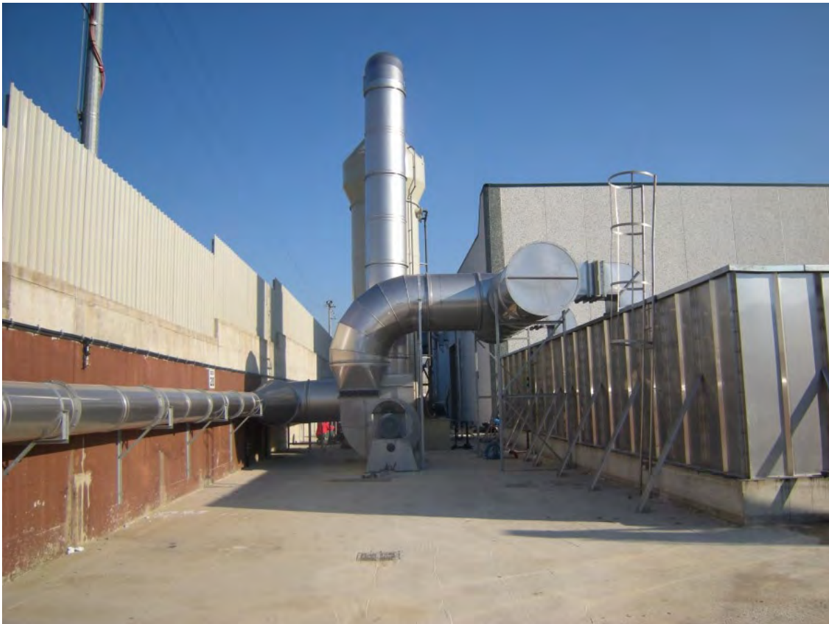
Fig. 2 impianto di aspirazione per allevamento dotato di scrubber e biofiltro
