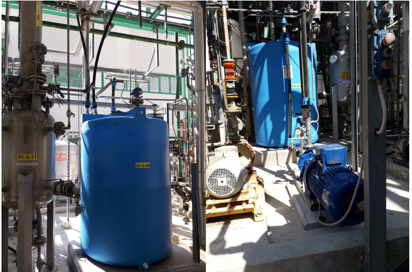
Fig. 2.2.4: vista d'insieme del serbatoio di equalizzazione, della pompa e delle linee di ingresso ed uscita
