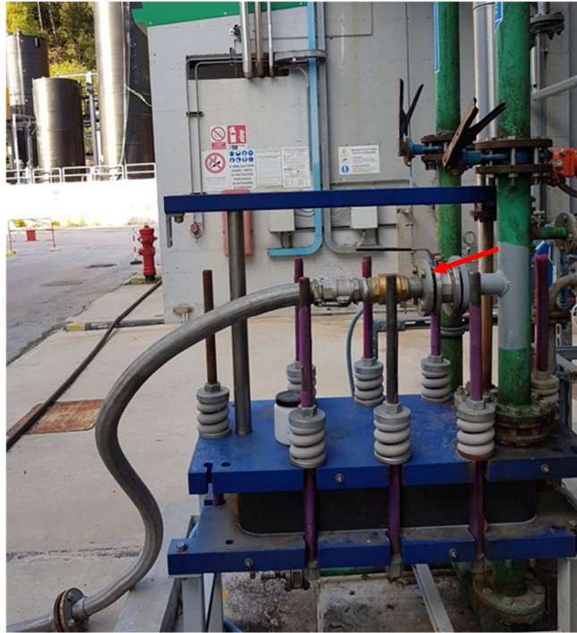
Fig. 2.2.9: punto di immissione al ciclo produttivo dell'acqua trattata
