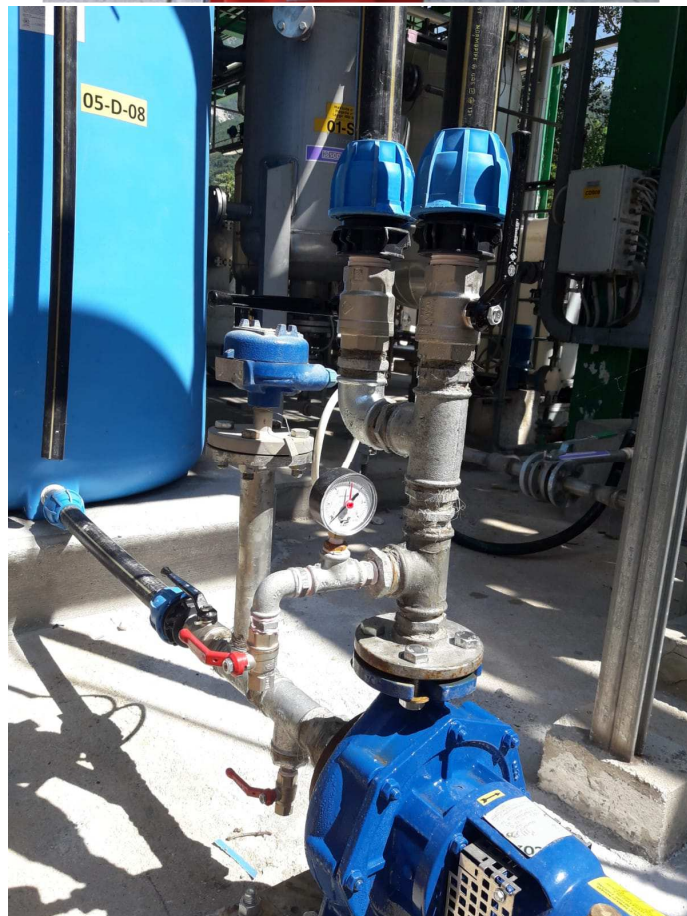
Fig. 2.2.6: punto di campionamento acque in ingresso al filtro
