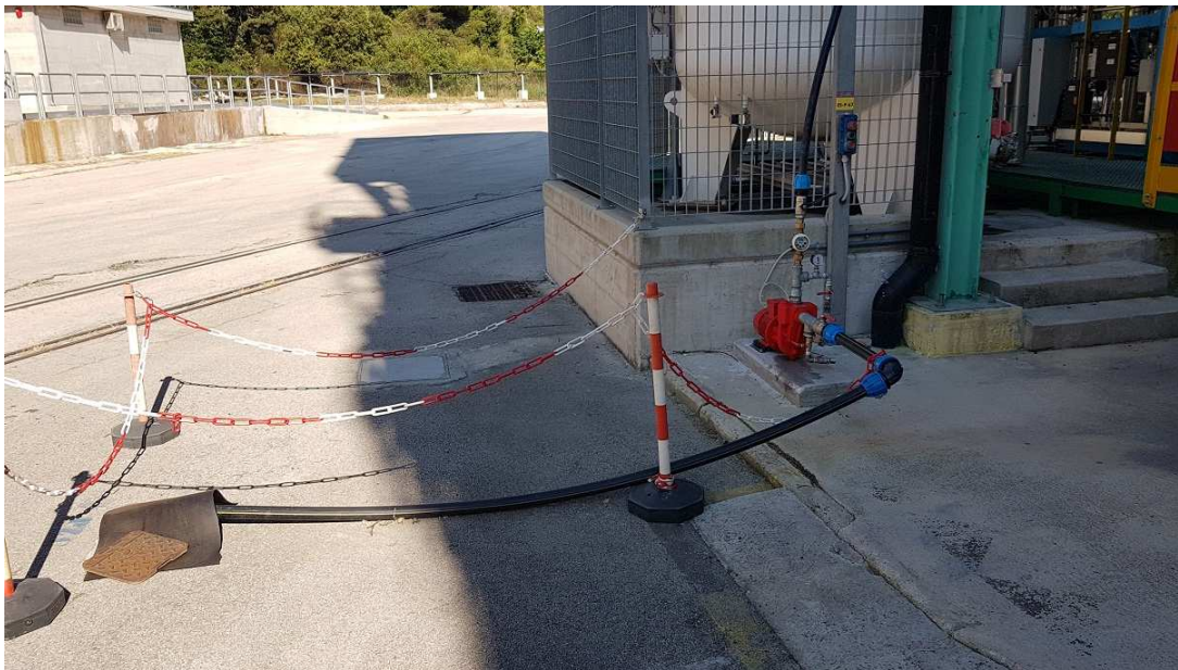
Fig. 2.1.2: tubazioni di aspirazione e mandata pompa 05-P-dal piezometro PZC
