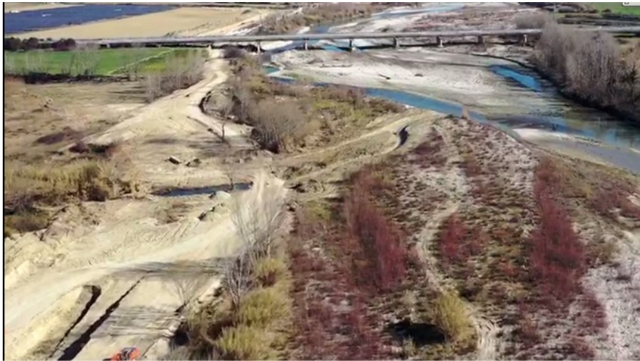
Area appena a monte l'autostrada. Si noti lo scavo del canale verso il fiume, non previsto nel layout di cantiere.
