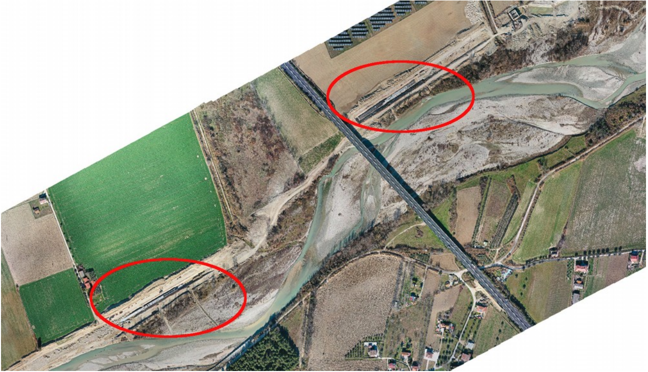
Rilievo dell'08/02/2020. Si notino i due tratti di canale in lavorazione contemporanea.
