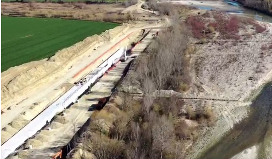
Fotogramma tratto dal video girato il 16/02/2020. Tratto appena a monte dell'autostrada. Si notino: le due piste a destra e a sinistra del canale in costruzione; la larghezza dell'area di cantiere; l'enorme quantità di terreno accumulato su entrambi i lati, i numerosi mezzi al lavoro.
