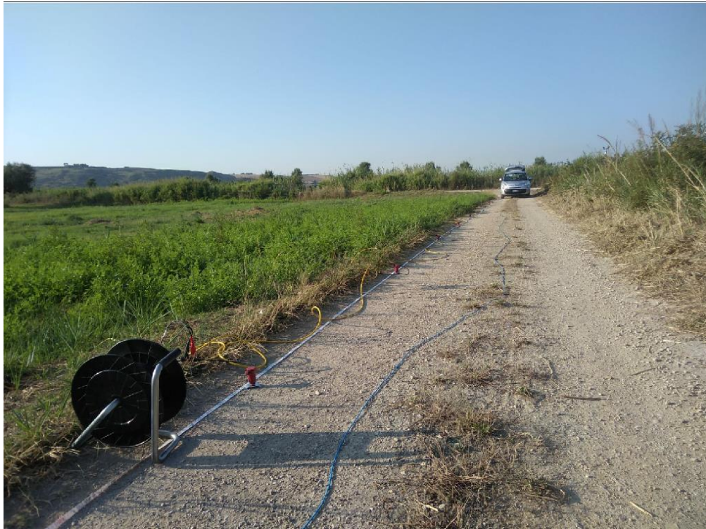
Strada pubblica sulla quale passerà il cavidotto interrato in prossimità della cabina di consegna
