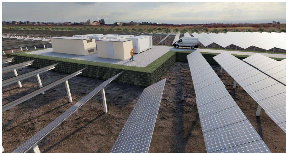
Vista di dettaglio della piazzola cabine
