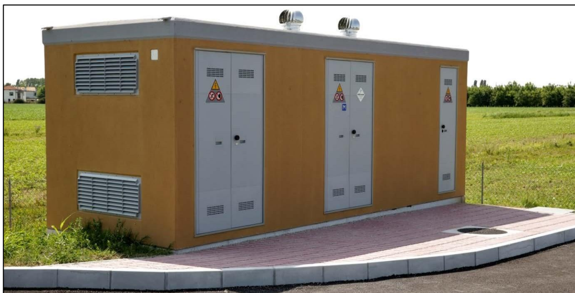
Immagine di una cabina di consegna specifica DG2092 Rev.03 del 15/09/2016
