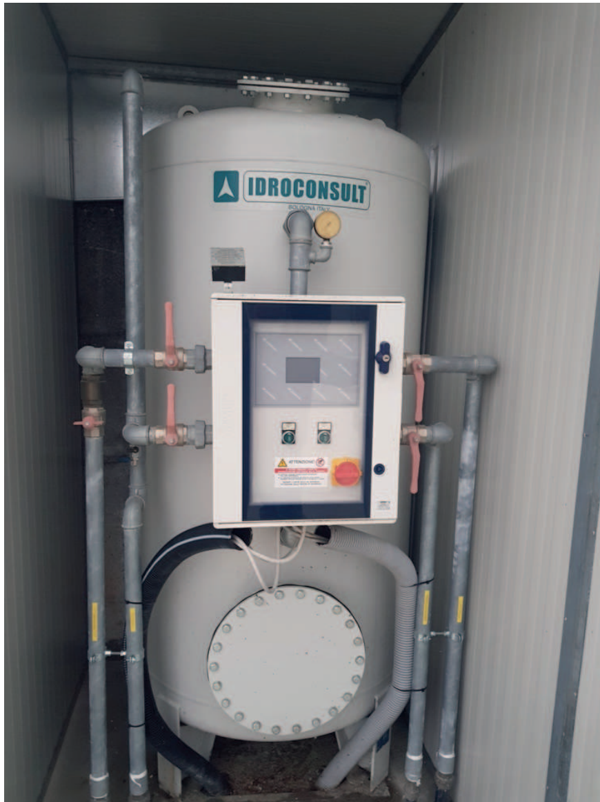
Fig. 42. Impianto filtrazione quarzo/zeolite
