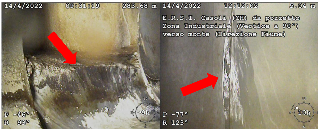
Figura 5-3 – Infiltrazioni da videoispezione nel collettore fognario a monte dell'impianto depurazione di Casoli
