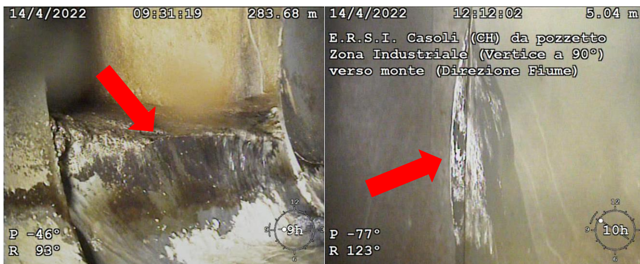
Figura 4-2 – Infiltrazioni da videoispezione nel collettore fognario a monte dell'impianto depurazione di Casoli
