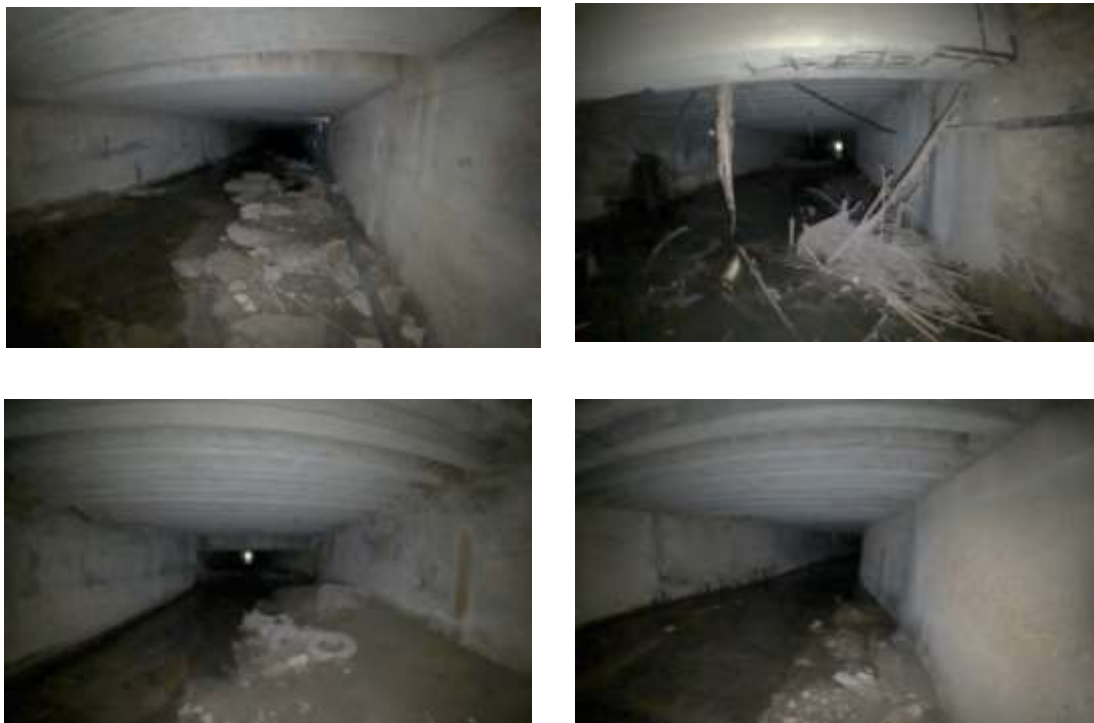
Figura 3.7: Video ispezione del tratto tombato: in alto si possono notare tratti del tombino dove si trovano accumuli di materiale, in basso a sinistra un abbassamento del cielo e in basso a destra un restringimento della sezione
