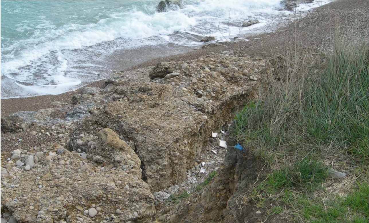
Figura 56. Esempio di smottamento nei pressi della falesia di Punta dell'Opera a ridosso del mare (ph: Giorgio Colangeli).
