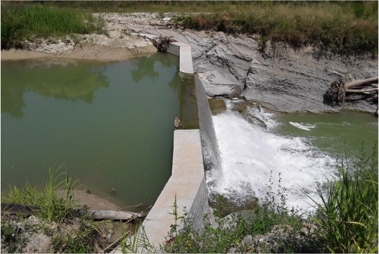
Figura 3: Briglia a monte dell'autostrada – 2018 – controbriglia distrutta
