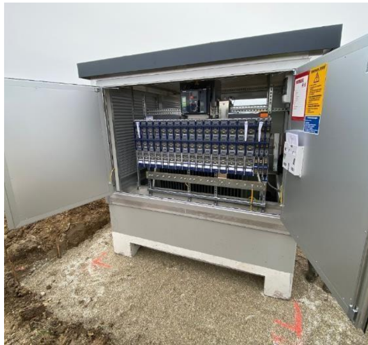
Fig. 5 – Cabina di Trasformazione
