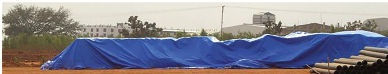
Esempio MPS/EoW coperte con geomembrana
