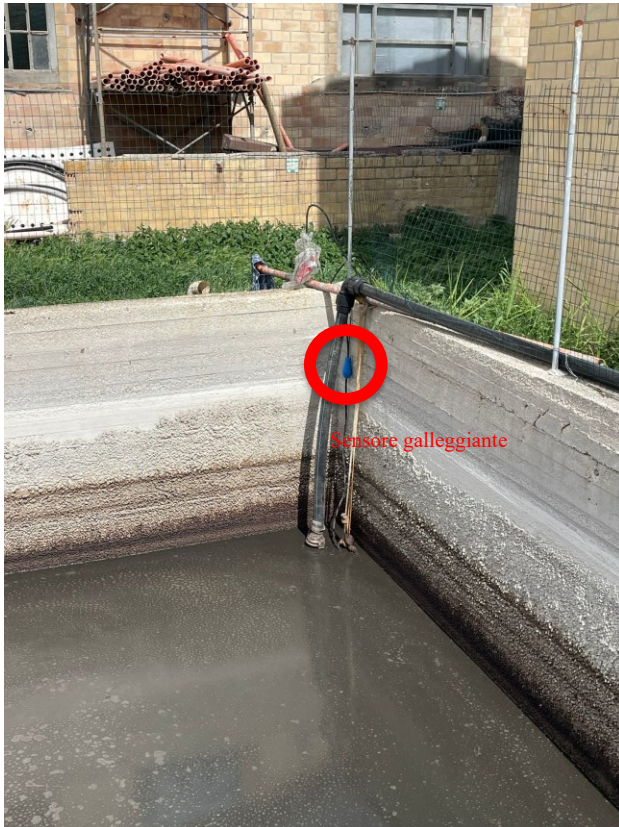
Foto 13: pompa ad immersione con sensore galleggiante vasca 1 in c.a.
