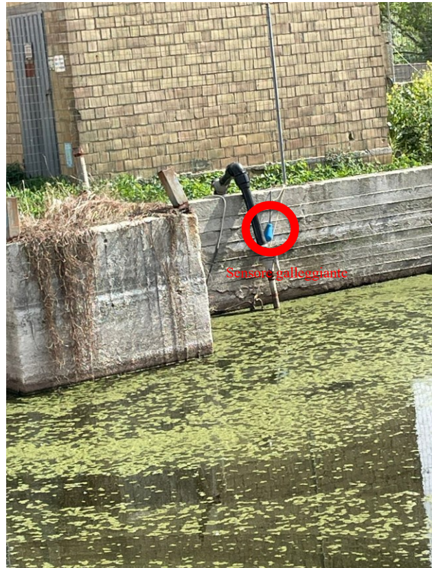
Foto 14: pompa ad immersione con sensore galleggiante vasca 2 in c.a.
