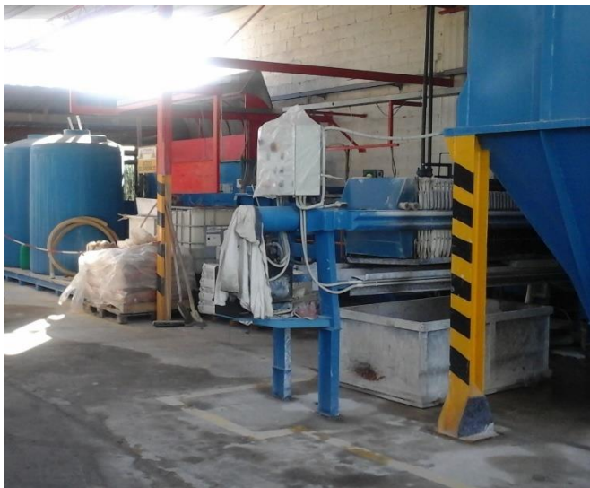
Foto 3: Impianto Chimico Fisico
