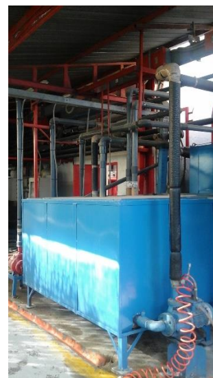
Foto 4: Impianto Chimico Fisico
