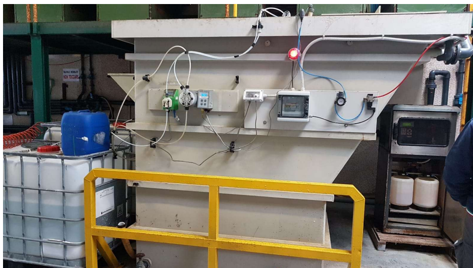
Foto 2: particolare impianto chimico fisico.
