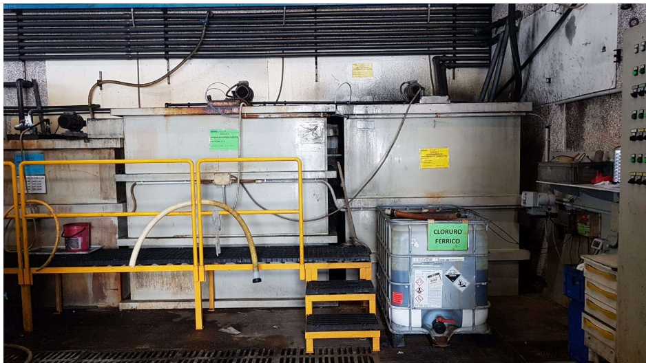
Foto 1: impianto chimico fisico
